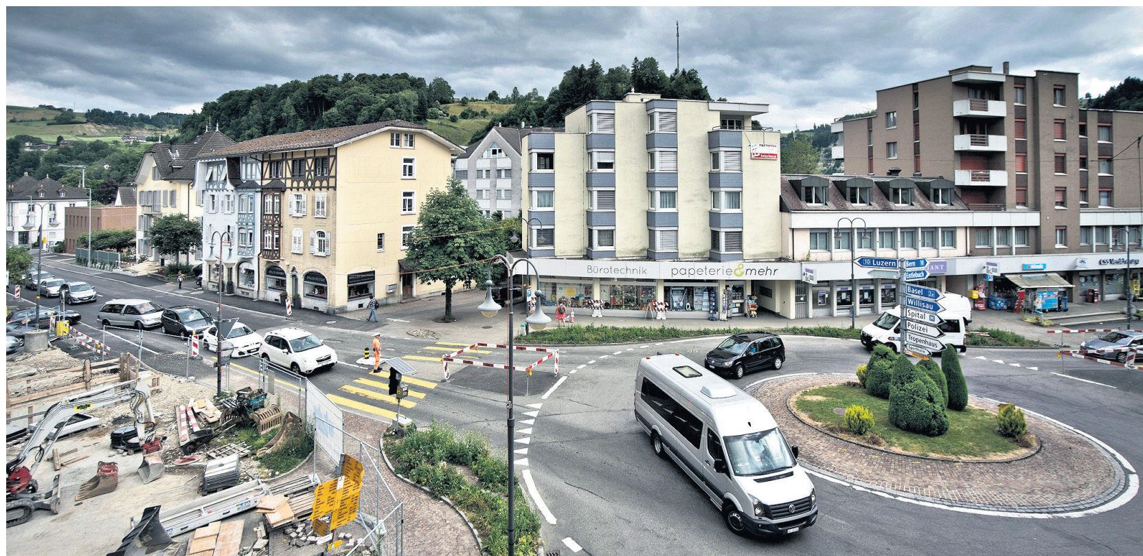
Die Kantonsstrasse in Wolhusen wird totalsaniert. Die Grossbaustelle mit einspuriger Verkehrsführung sorgt deswegen immer wieder für Wartezeiten. Unser Bild zeigt die Verkehrssituation am Rössli-Kreisel.
